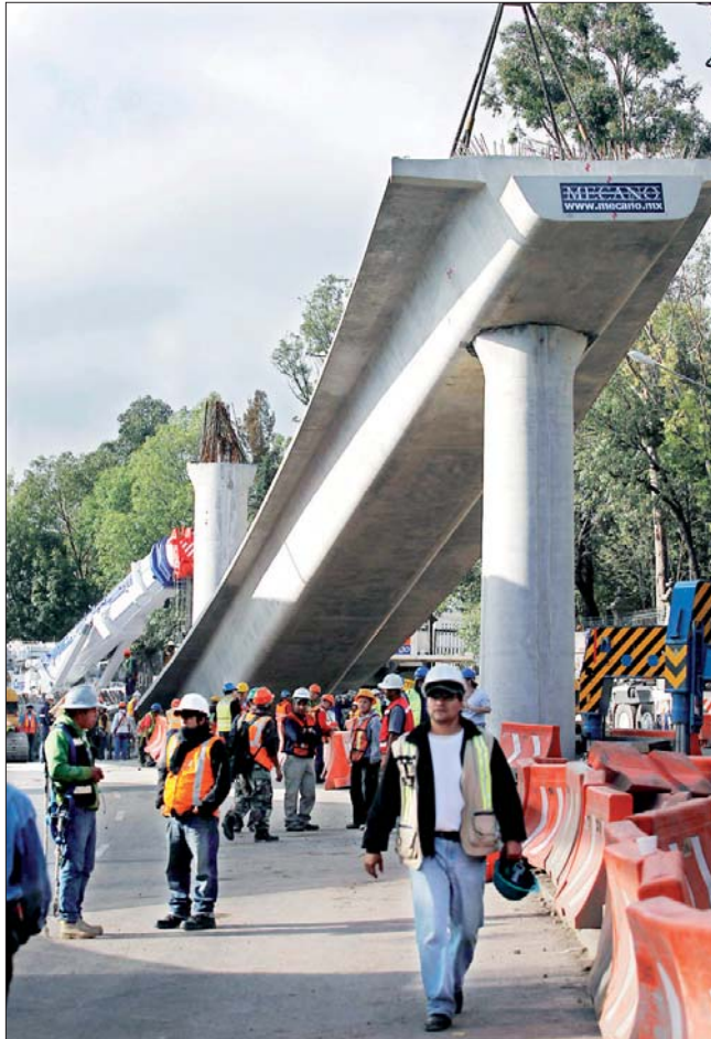
La deficiente colocación de una ballena de 20 metros de largo por tres de ancho, con peso de 280 toneladas, provocó que dos trabes no la soportaran y se viniera abajo en las obras del segundo piso que correrá por el Periférico, a la altura de avenida del Conscripto. Una grúa que participó en las maniobras también resultó dañada ■ Foto Yazmin Ortega Cortés
