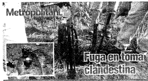
Nuevamente en San Juan del Río, se registra no sólo el hallazgo de una nueva toma clandestina, sino una fuga de combustible que pudo dañar al ecosistema
